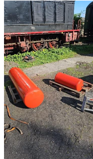
Ausgebaute Bremsluftzylinder der V 36 406
